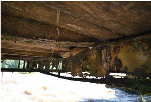
3 Untersicht der bestehenden Brücke mit massiven Korrosionsschäden und plastischen Verformungen © Andreas Galmarini
