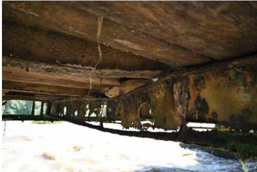
3 Face inférieure du pont existant avec une structure massive Dommages dus à la corrosion et déformation plastique © Andreas Galmarini
