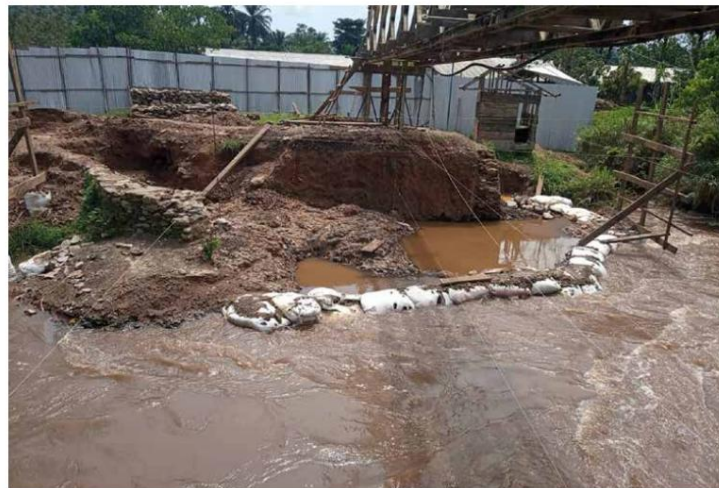
12 inondations lors de la construction du Pont Neuf
