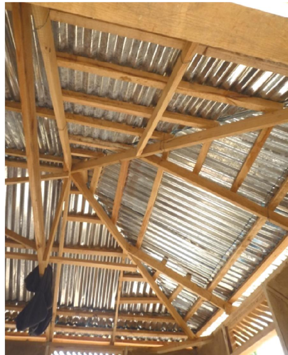
Vue de la structure de la toiture, avec les lattes renfort dans les angles.
