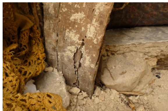
Poteau planté dans la sol et dégradé par les termites. Détail la liaison du soubassement et de la charpente.
