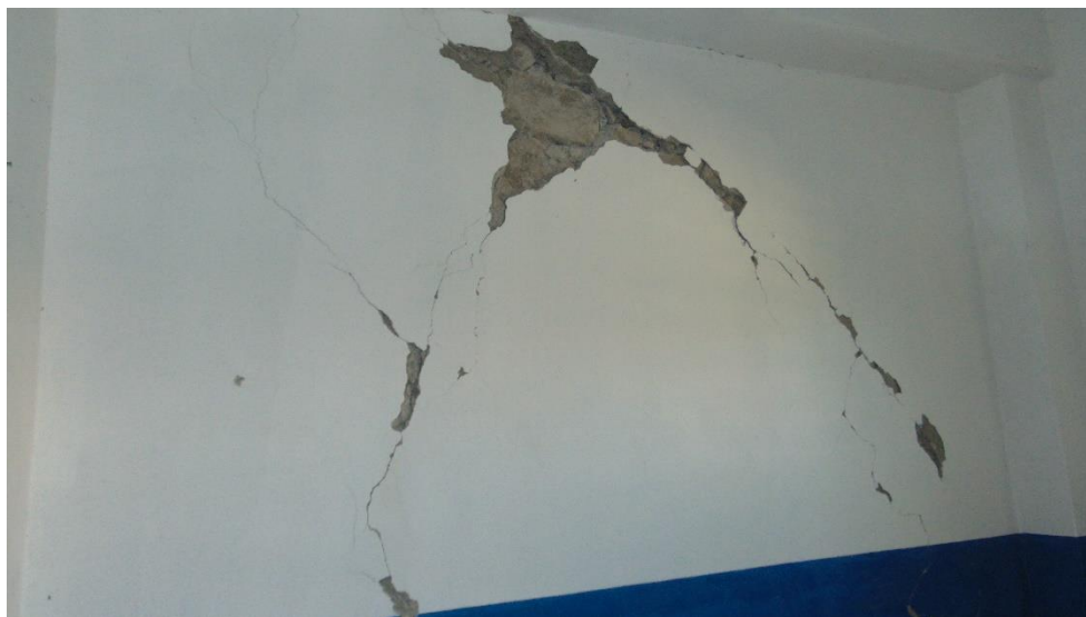
Figure A1. Exemple de fissures en X
