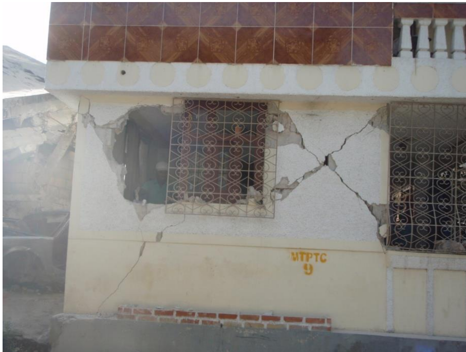
Figure B1. Exemple de fissure en X
