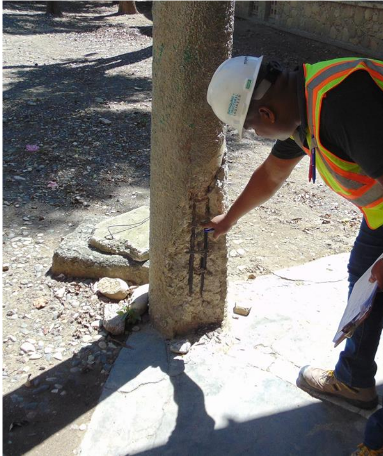
Figure G1. Exemple d'une colonne en béton écaillé
