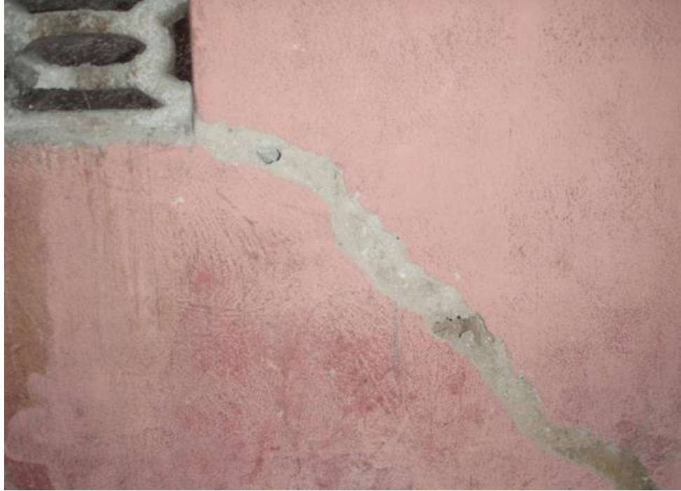
Figure F1. Exemple de fissure mineure
