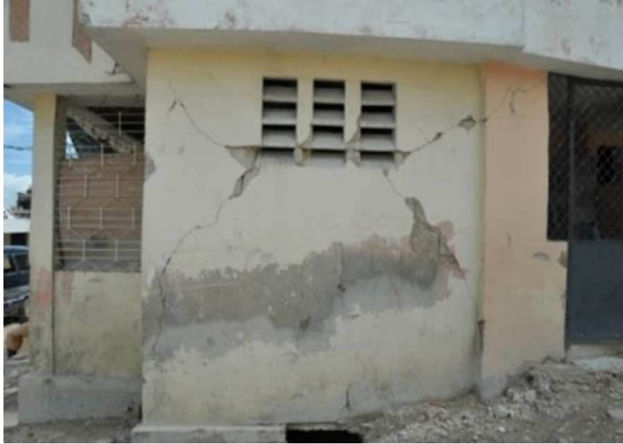
Figure B2. Exemple de fissure en X
