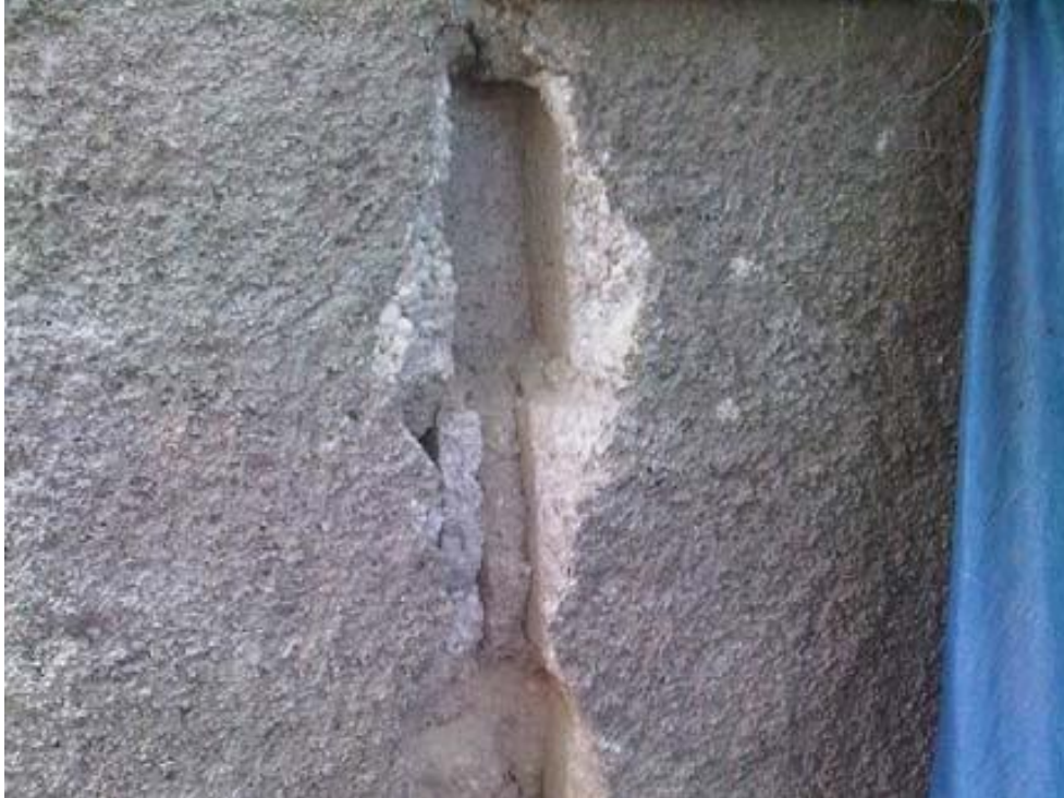
Figure F2. Exemple de fissure modérée
