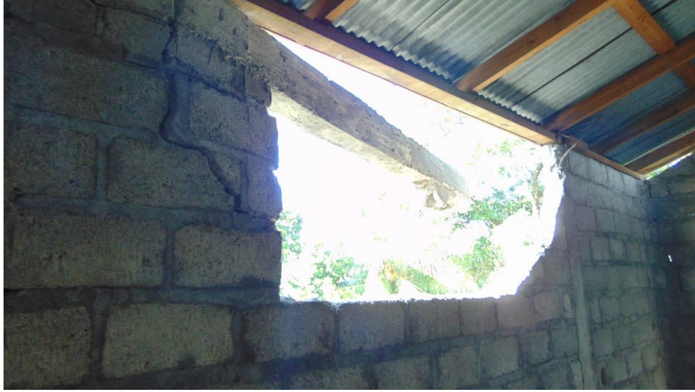
Figure D1. Exemple d'un linteau endommagé
