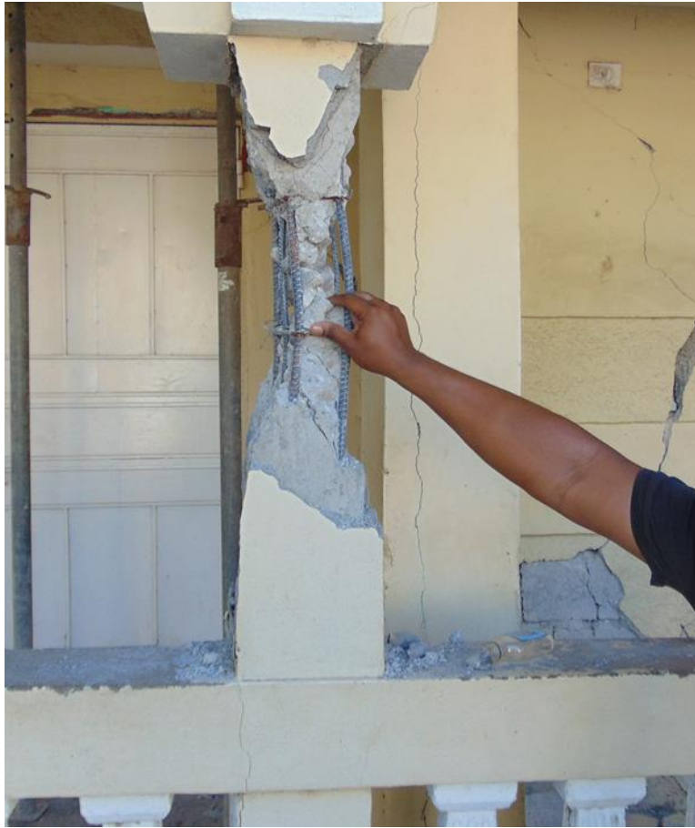
Figure H3. Exemple d'une colonne en béton endommagée
