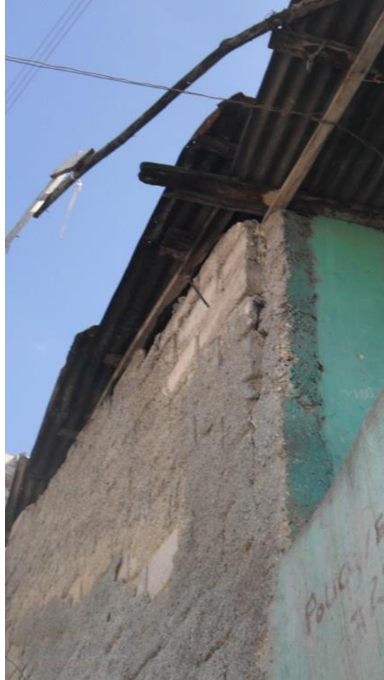
Figure C1. Exemple d'un mur déplacé
