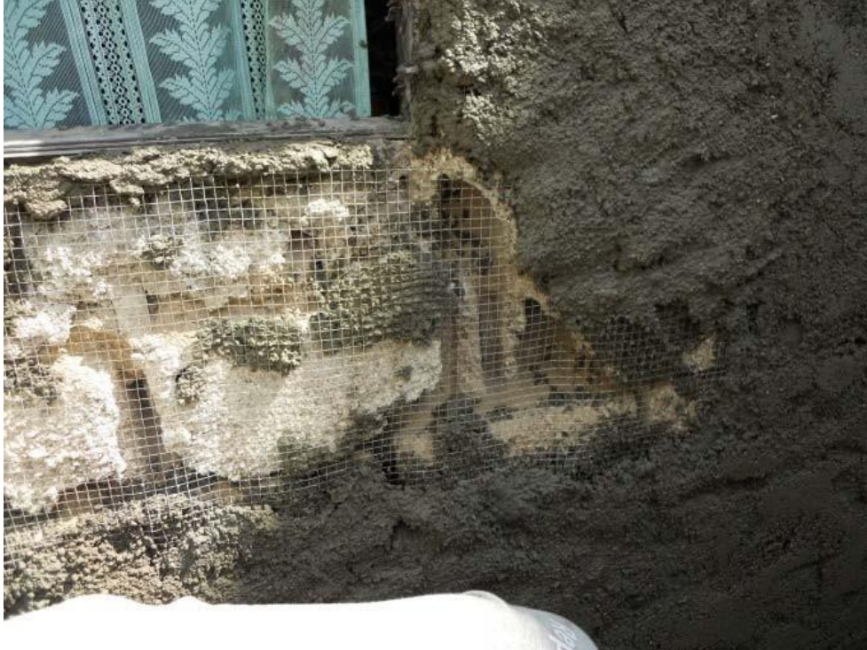
Figure F3. Exemple d'un mur avec des blocs de mauvais qualité
